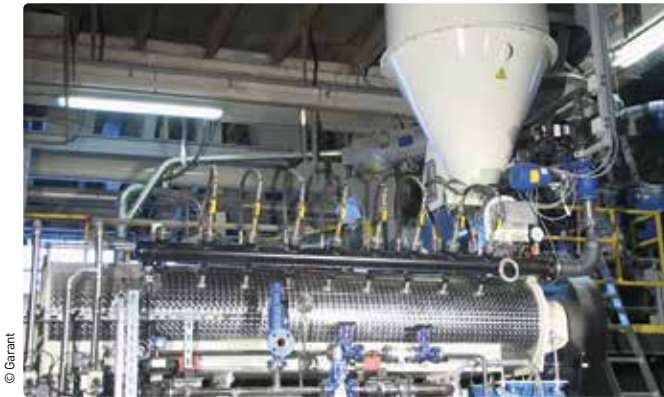
Hochmoderne Extruderanlage im Garant Mischfutterwerk Aschach an der Donau
